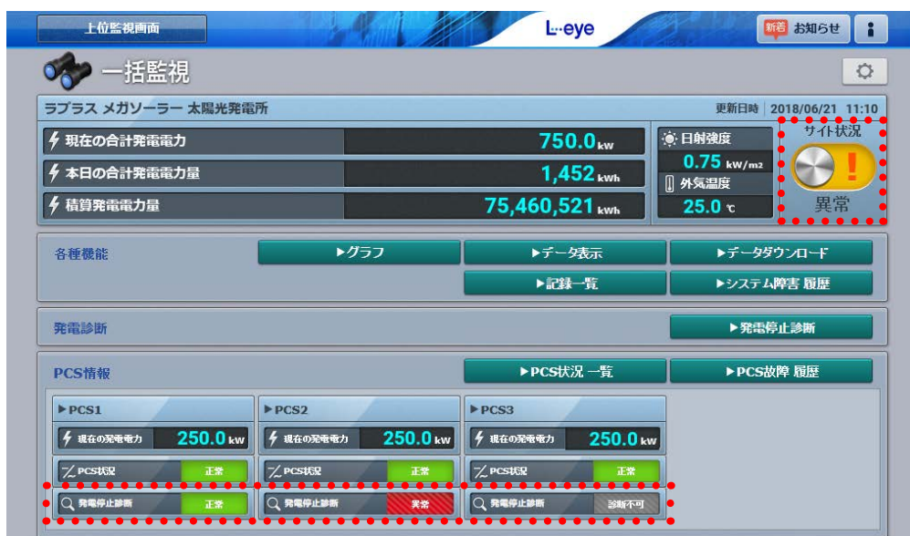
一括監視画面（発電停止診断を「ON」にしている場合）
